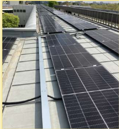
U1 Kaisermühlen 242 kWp
